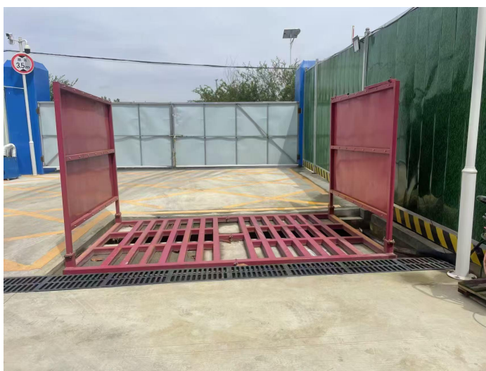
图3 项目区洗车设施 (2025.1)
